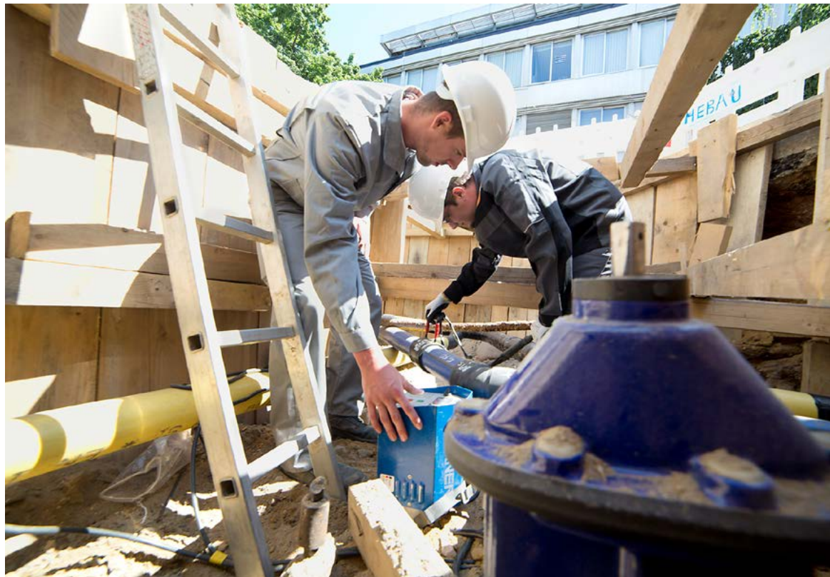
Ein gut gepflegtes Trinkwassernetz vermeidet Wasserverluste
