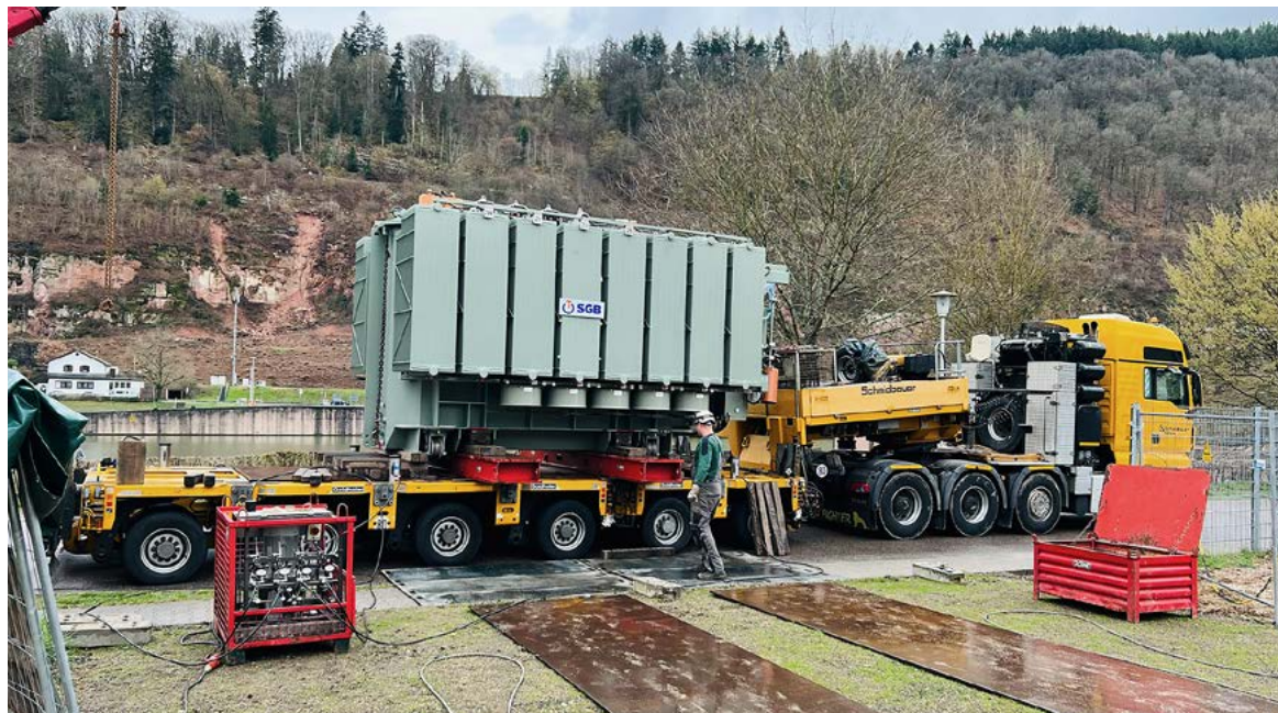
Der neue Transformator für die Umspannanlage Hirschhorn
