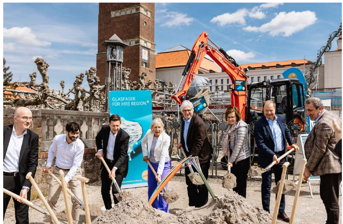
Spatenstich für den Glasfaserausbau der Mathildenhöhe im April 2023. Ein weiterer Meilenstein für den Ausbau des Glasfasernetzes. Mit dabei die Hessische Ministerin für Digitale Strategie und Entwicklung, Prof. Dr. Kristina Sinemus (4. v. l.), Darmstadts Oberbürgermeister Jochen Partsch (Mitte) und Dr. Marie-Luise Wolff, Vorsitzende des Vorstandes von ENTEGA.
