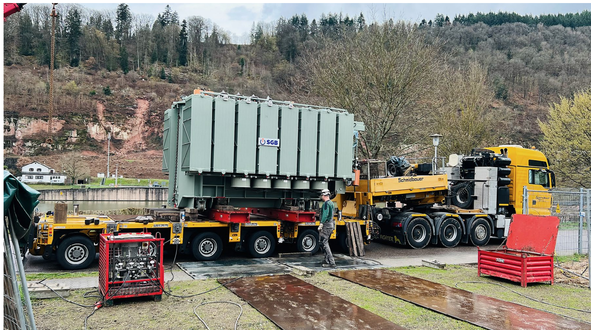
Der neue Transformator für die Umspannanlage Hirschhorn
