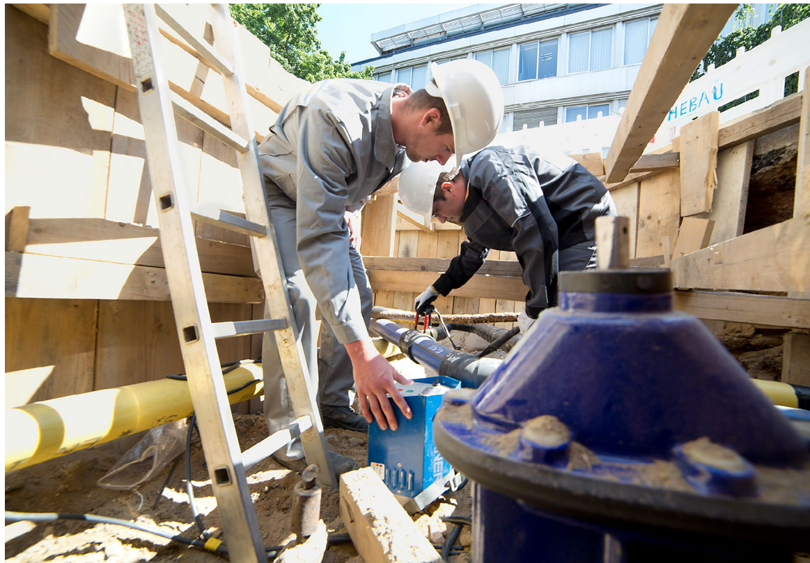
Ein gut gepflegtes Trinkwassernetz vermeidet Wasserverluste
